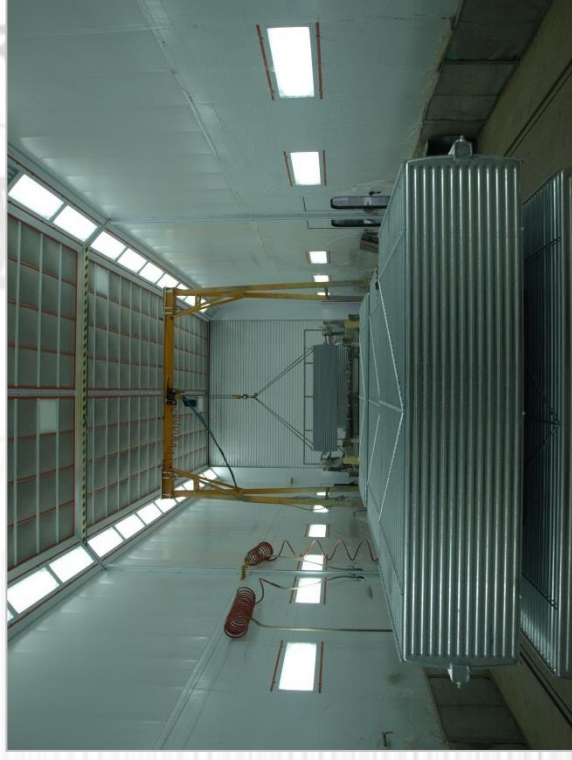
Radiatory w kabine lakierniczo-suszarniczej
