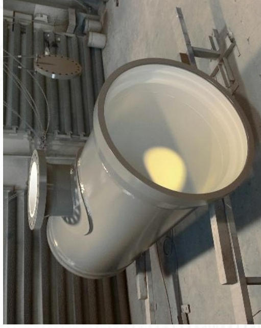
Trójnik Do hydroelektrowni
